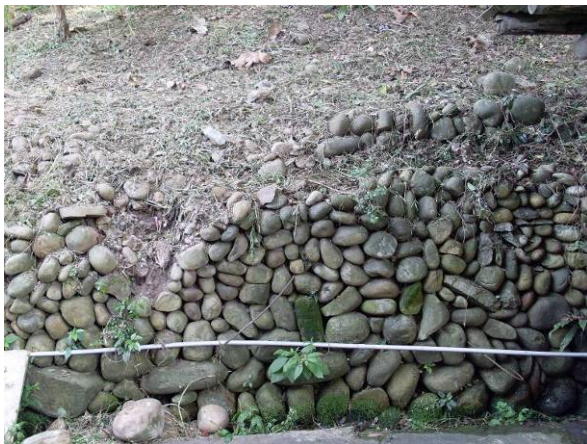
袁家壘石駁坎因為地震坍塌， 本案攝
